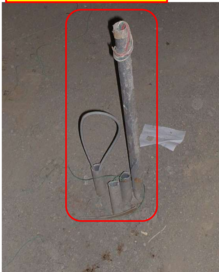
缺失：管口未以管帽封閉
