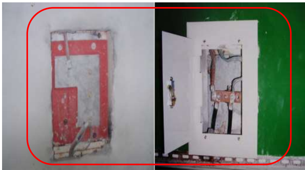
接地電阻測試箱施作 缺失 照片
